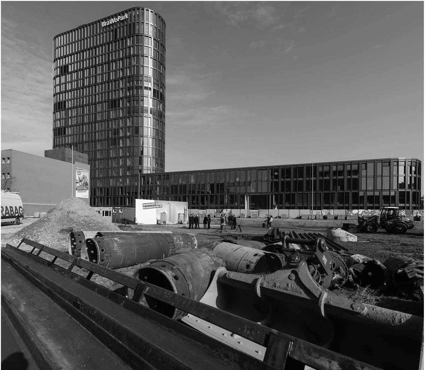
Die neue Baustelle des BC III. Im Hintergrund befindet sich das Nachbargebäude BC II.
