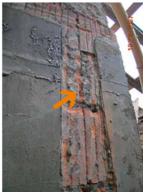
Abb. 5: durchgehender Bruchriss im Mauerwerk. Die einbindenden Ziegel sind senkrecht gebrochen
