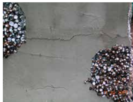
Abb. 3: Risse in der Kehle
