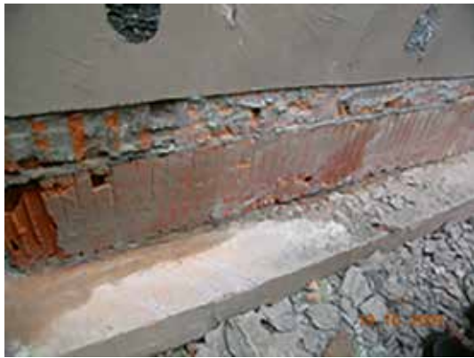
Abb. 6: In Höhe der Horizontalsperre hatten sich durchgehende Risse gebildet
