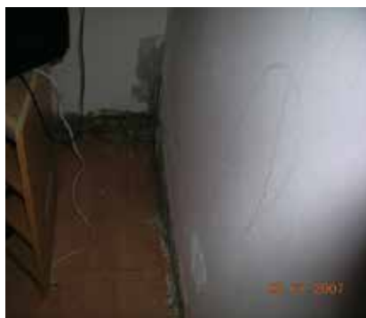
Abb. 1: Schadensbild an der Außenecke
