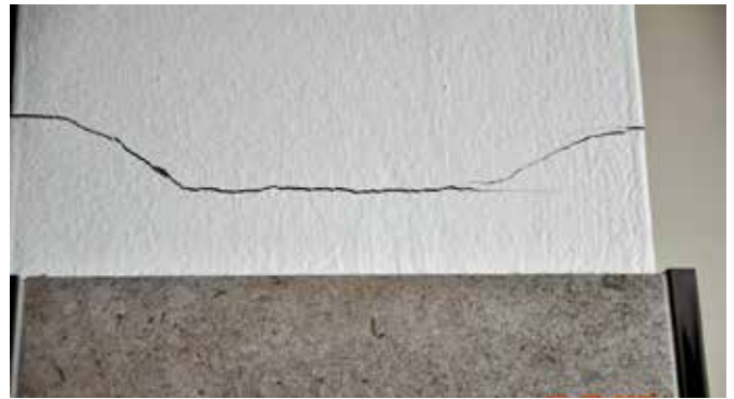
Abb. 8 Riss im rechten Wandschaft
