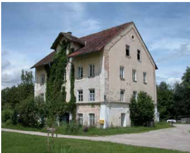
Das Gebäude zeigte sich zu Beginn der Sanierungsarbeiten in einem äußerst schlechten baulichen Zustand. Bild: Gemeinschaft Blumenthal
