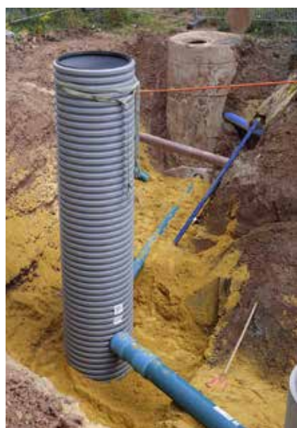
Das in den KS-Bluebox®-Elementen gesammelte Niederschlagswasser gelangt in den Drosselschacht von Funke und wird von hier sukzessive in die Kanalisation abgegeben. Foto: Funke Kunststoffe
