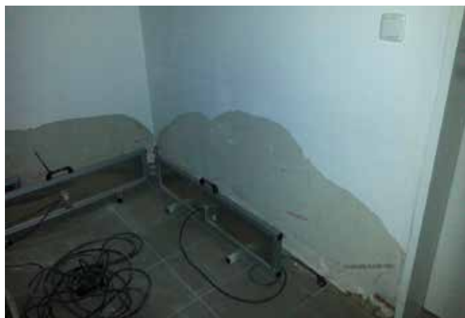
Abb. 1: aufsteigende Feuchtigkeit an den Innenwänden
