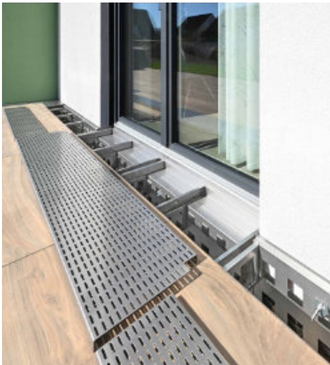
Wohnhaus Friedrichsdorf: Drainagerinnen Stabile Air
