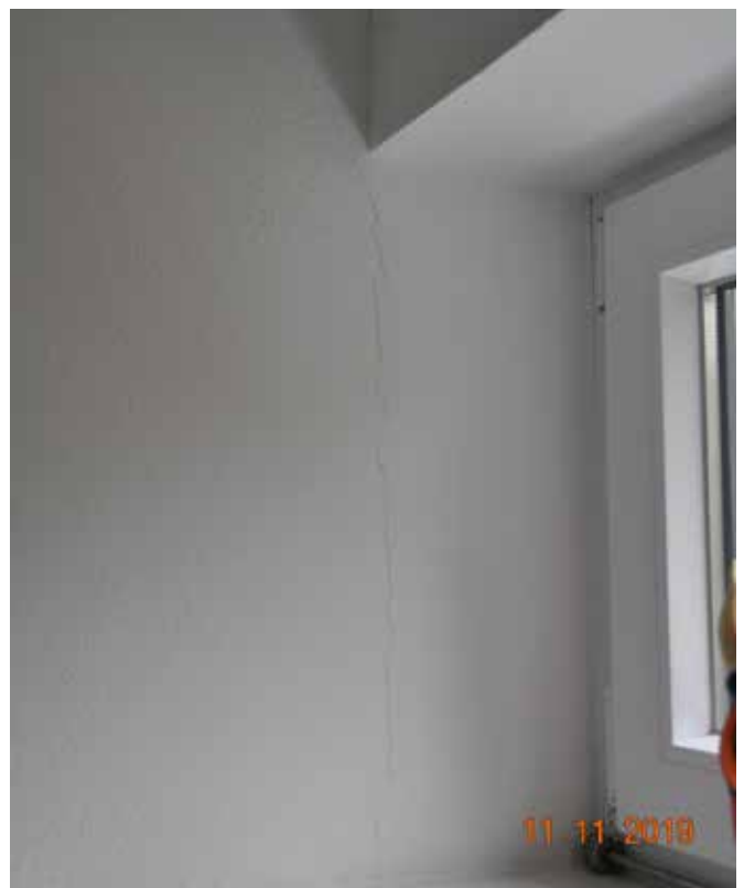
Abb. 11: Riss zwischen Innen- u. Außenwand
