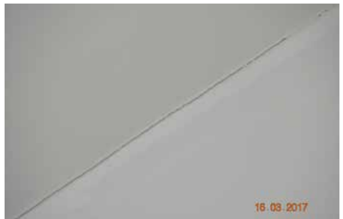
Abb. 6: Riss zwischen Dachschräge und Giebelwand
