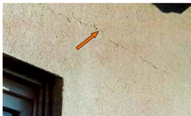
Abb. 2: Schollenbruch am Außenputz in Deckenhöhe
