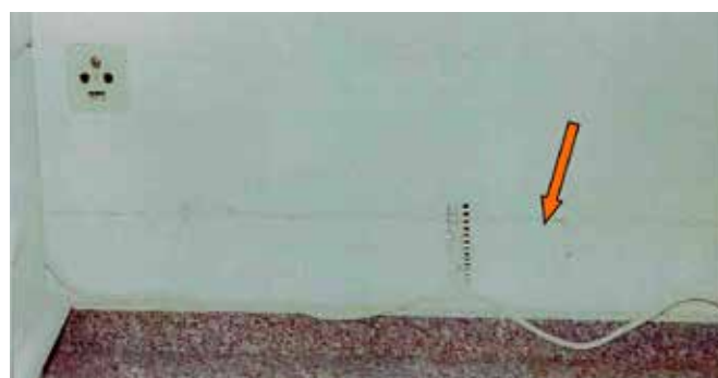
horizontaler Riss auf der Innenseite
