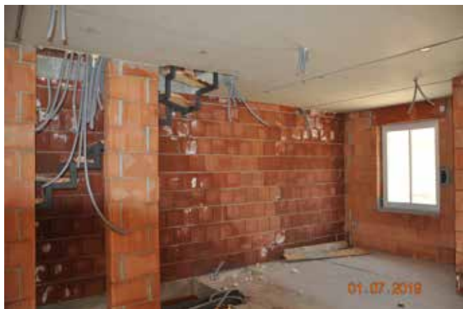
Abb. 8: Gebäudetrennwand nach Flutung der Trennfuge infolge Starkregen
