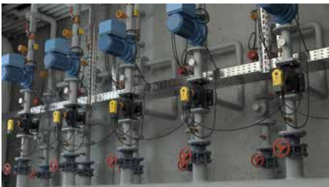
Beispiel: Einsatz in einer Heizungsanlage, Quelle: SAUTER
