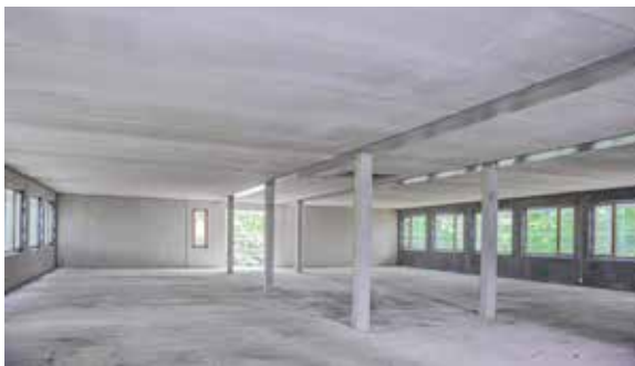
Slim Floor-Konstruktionen mit störungsfreien Unterseiten ermöglichen einfache Leitungsführungen in der Bauphase und bei späteren Nutzungsänderungen. Auch der Flurbereich mit den kurzen Spannweiten wurde im Zuge einer optimierten Baustellenabwicklung mit BRESPA®-Decken eingedeckt. Foto: DW SYSTEMBAU GMBH
