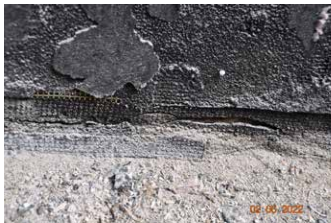
Abb. 1 Schrumpfriss am Übergang zur Bodenplatte an einer Kombinationsabdichtung
