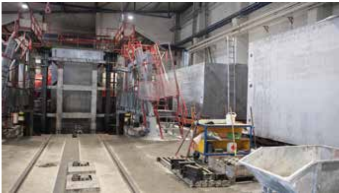
Betonierstation mit Kippkolben
