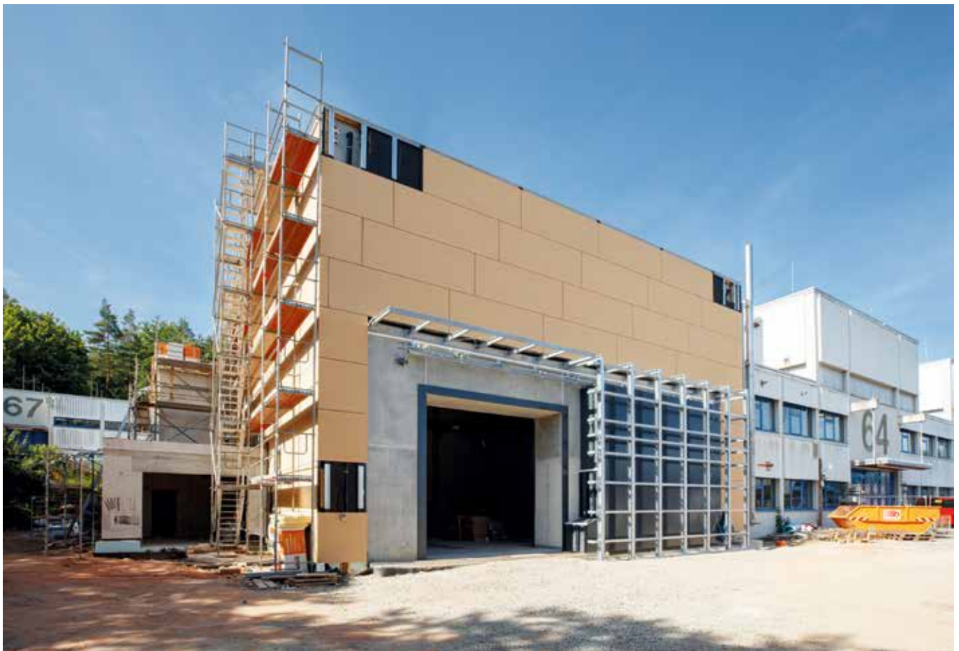
Das Schiebetor aus Spezialbeton ist so ausgelegt, dass Lkw mit Untersuchungsmaterial ein Stück weit in die strahlensichere Forschungshalle einfahren können. Foto: view
