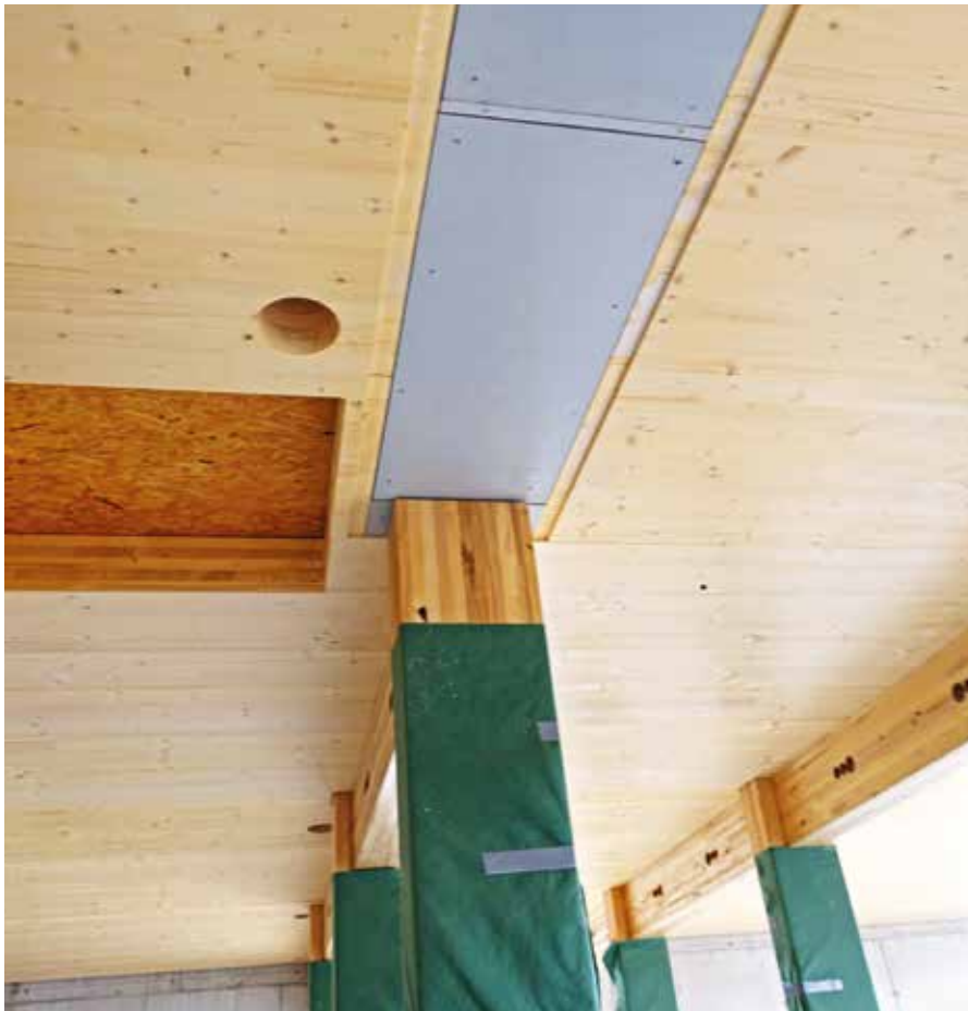
Brandschutz im Holzbau: An der Unterseite deckengleicher Stahlträgern sind Brandschutzplatten angebracht. Zur Wahrung der Holzoptik wird noch ein Abdeckbrett ergänzt. Foto: Fast + Epp
