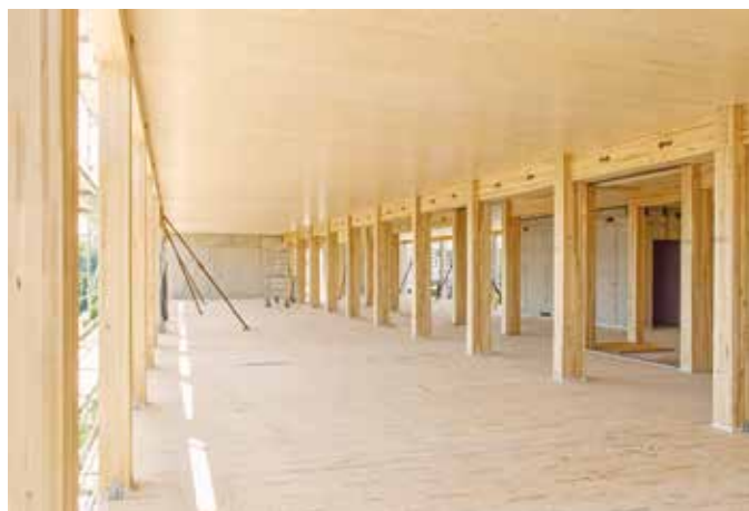
Brettspertholz-Deckenelemente, Unterzüge und Pendelstützen, die in den Flurachsen als Gabelstützen ausgebildet sind Foto: Fast + Epp
