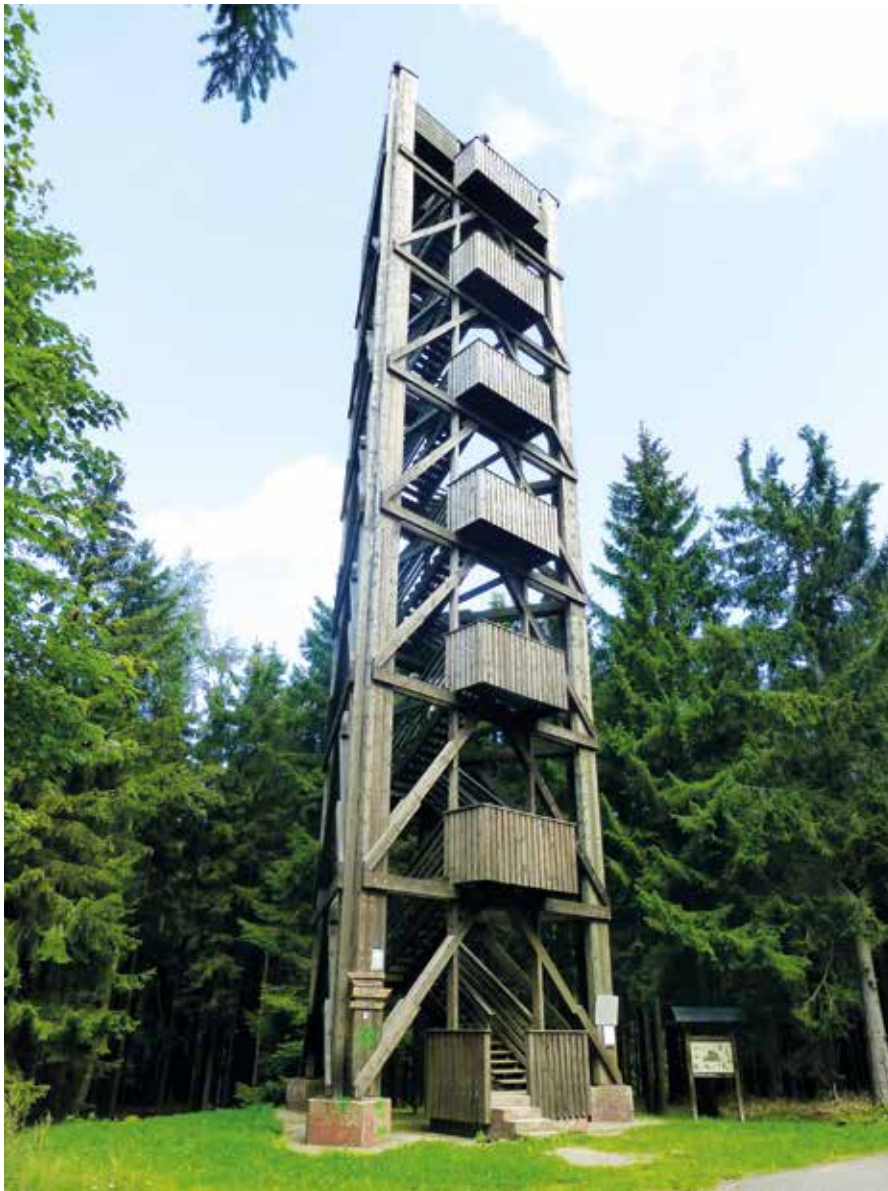
Der alte, 24 m hohe Aussichtsturm musste abgerissen werden. Ein Brand hatte ihn stark beschädigt. (Foto: wikimedia commons)
