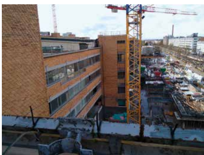
Blick auf die Baustelle aus einer der oberen Etagen an der Fürther Strasse mit Blick auf den U-Bahnhof und die Fürther Str. rechts im Bild. Oben rechts im Bild sieht man das Gelände und die ehemaligen AEG Gebäude die auch erhalten und umgenutzt wurden
