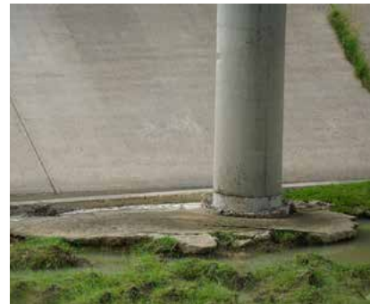
Erosion/ Kolkbildung an einem Brückenpfeiler
