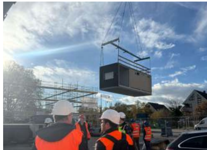
Die ersten Module für das Hallenbad schweben über den Kelterplatz in Zuffenhausen. Bild: IBA'27 / Thea Leisinger
