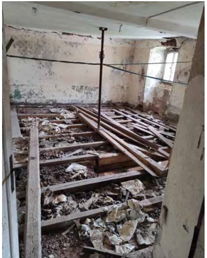
Notsicherung Stuhlkonstruktion (gebrochener Untergurt, fehlende Strebe)
