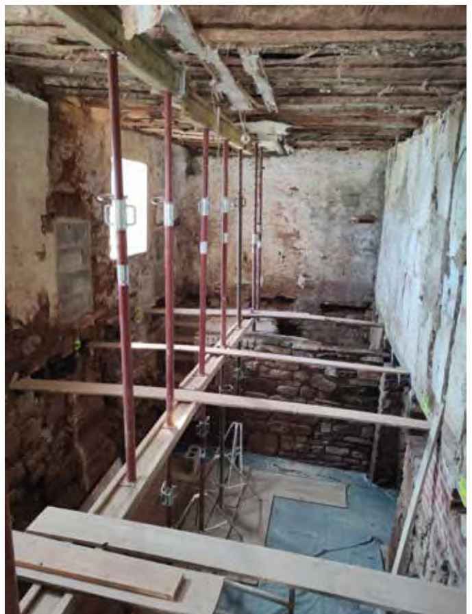
Bild oben: Rückbau Decke über dem Kellergeschoß (Holzbalkendecke), Bild links: vorgefundene Decke über Erdgeschoss mit oberseitigem gemauertem Kamin (ca. 7 m hoch)
