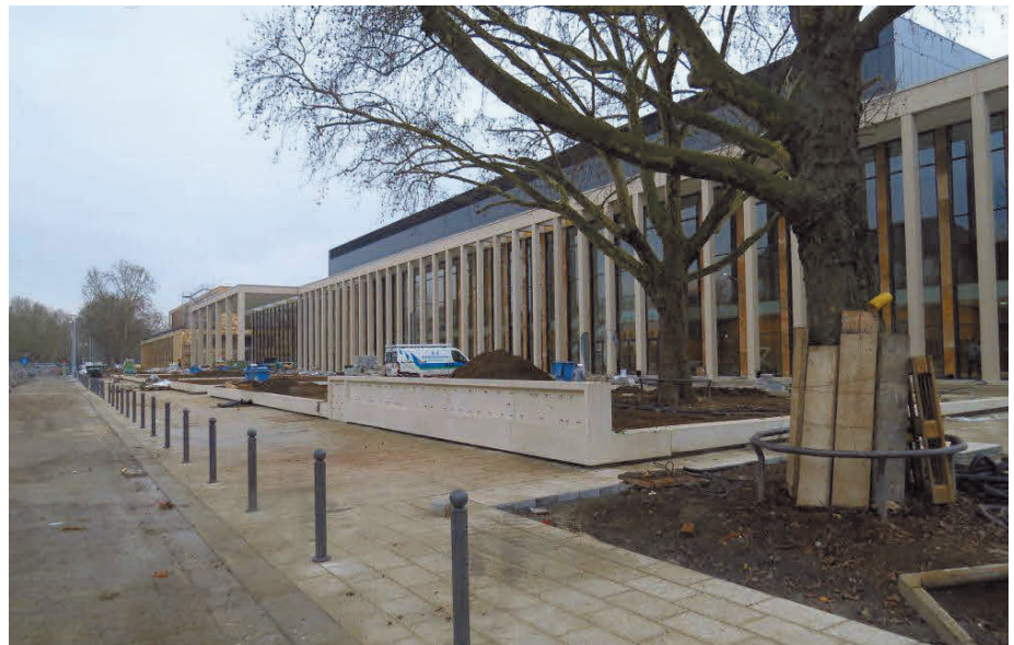
Außenbereich. Das RMCC Wiesbaden mit umgestaltetem Vorplatz an der Friedrich-Ebert-Allee - Ecke Rheinstraße. © Christian Bartha
